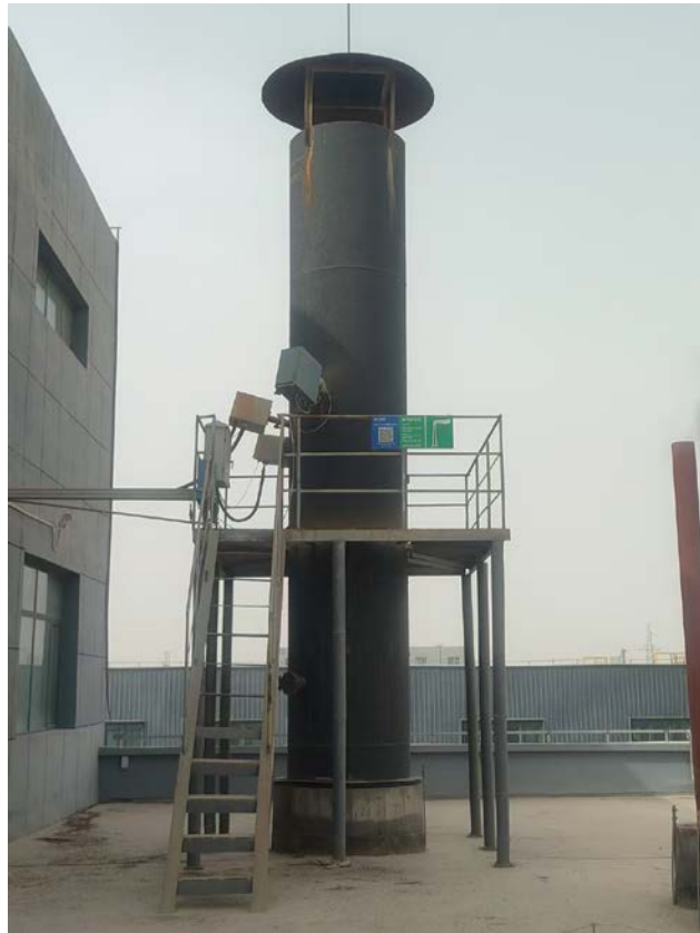
20m 高排气筒
